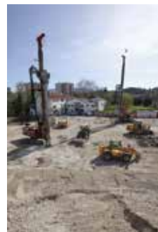
Centre de maintenance du Tramway d'Aubagne FRANCE
