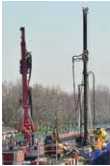
Tunnel Connaught - Londres ROYAUME-UNI
